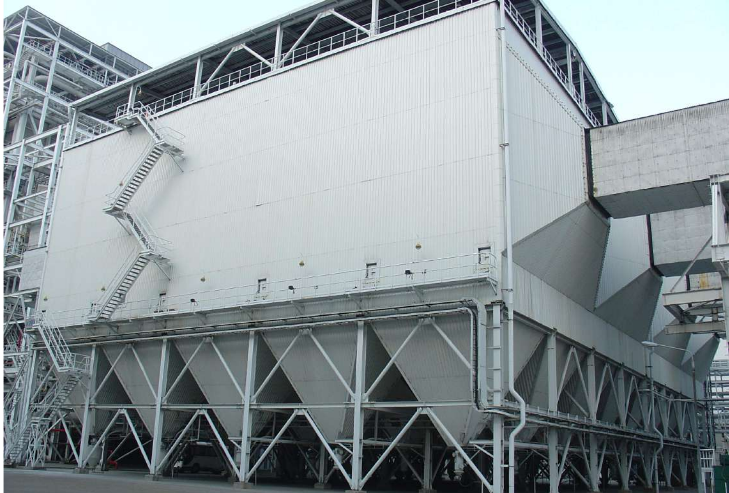
大型火电厂电除尘装置
